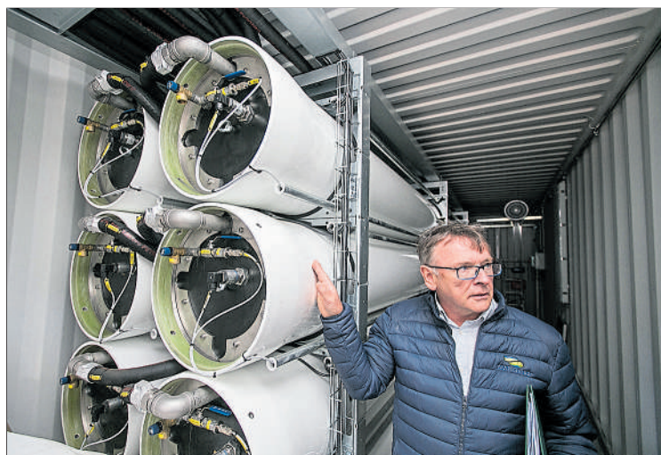
Marcel Wilwert mit dem Herzstück der mobilen Reinigungsanlage, die aus zwei Containern besteht: die sechs Meter langen Membranfilter.
